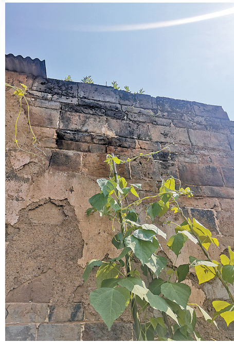
袁家大屋只剩一面残墙。（本报记者 罗福摄）
