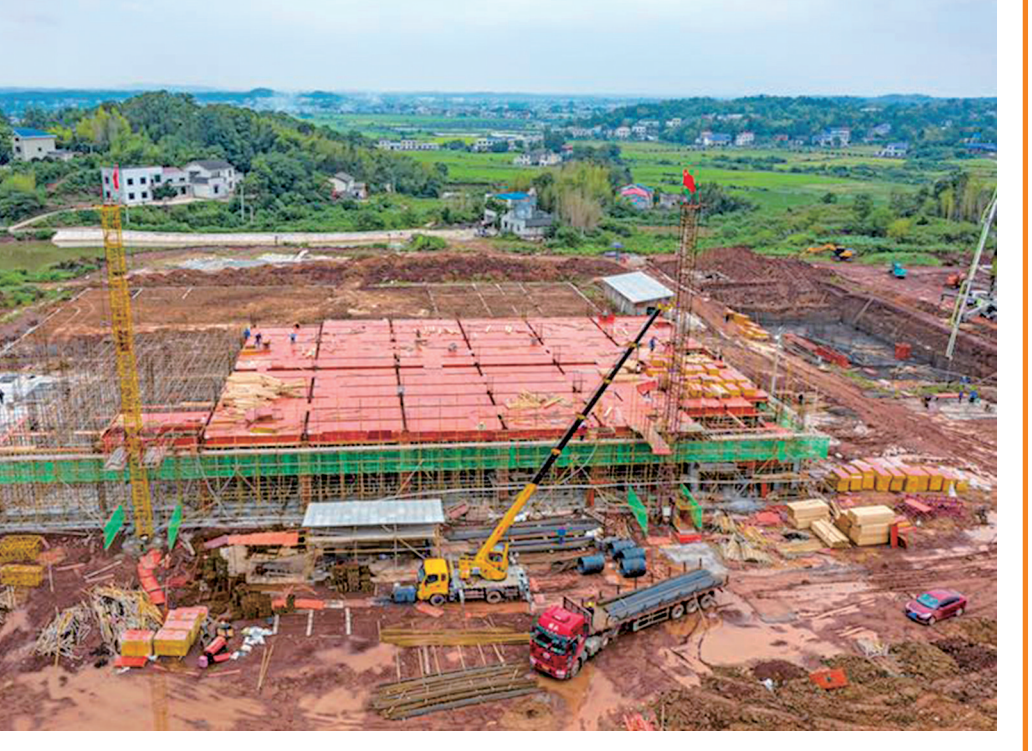
花石湘莲加工产业园(一期)项目现场一派繁忙，施工人员正抢抓工期，加快建设。(本报记者 方阳 摄)
