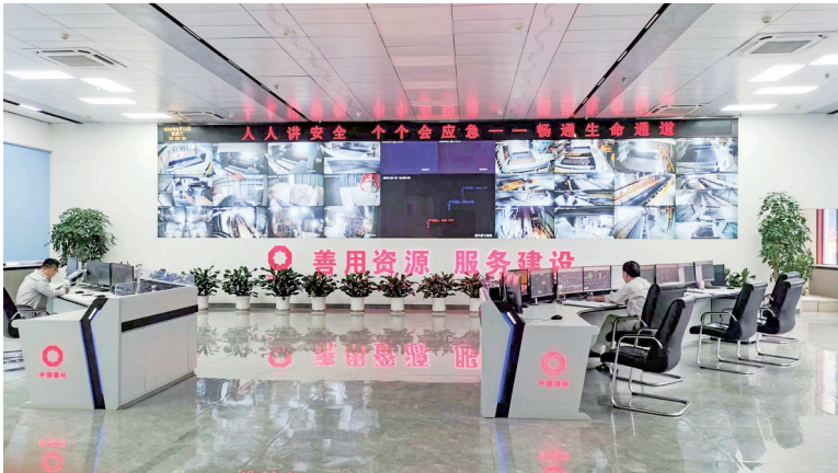
湖南韶峰南方水泥有限公司中央控制室。
